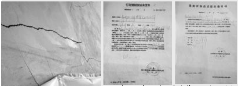
↑一层的墙体裂缝。
